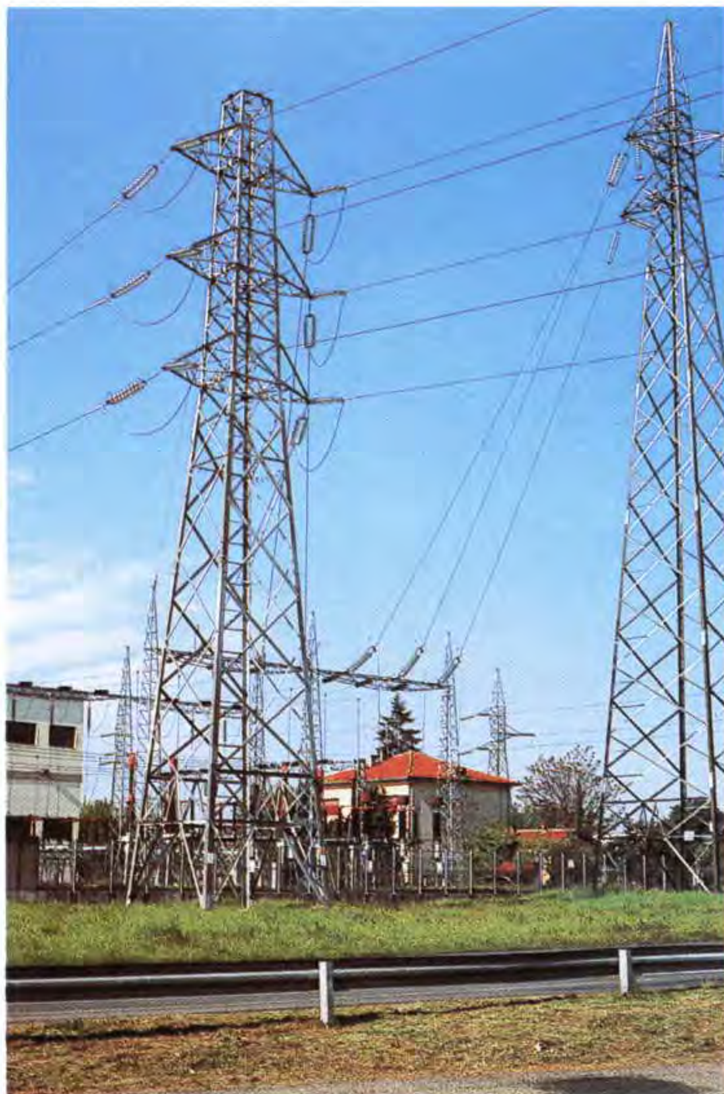
Fig.4 Chi abita in prossimità di una Centrale elettrica rimane esposto per mesi e anni interi ad intensità ELF superiori ai valori minimi consentiti, che possono provocare disturbi vari e danni alla ghiandola pineale ed al sistema immunitario.
