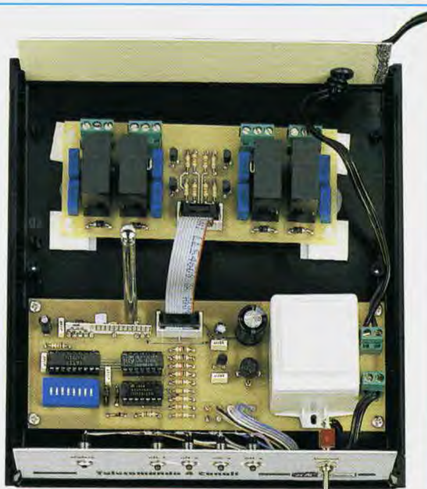
Fig.24 In questa foto potete vedere il circuito LX.1412 di fig.32 che si differenzia dal circuito LX.1411 perchè utilizza 4 relè. Alle morsettiere a 3 poli, poste vicino ad ogni relè, fanno capo i contatti A-B-C. A relè diseccitato risulteranno chiusi i contatti B-A e a relè eccitato risulteranno chiusi i contatti B-C (vedi fig.32).
